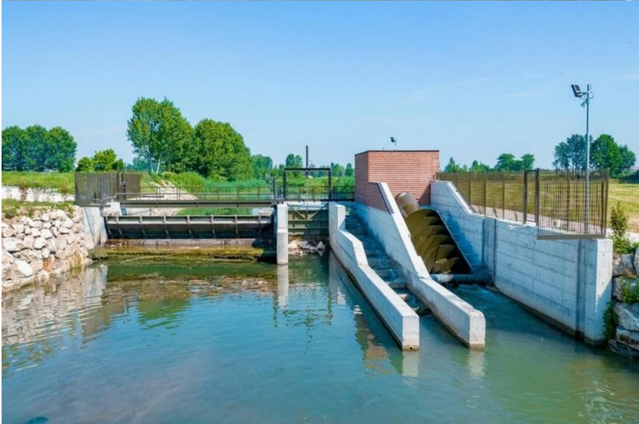
La nuova centralina sul fiume Gambara (BS) . La turbina ha una potenza massima di 100 kw.
